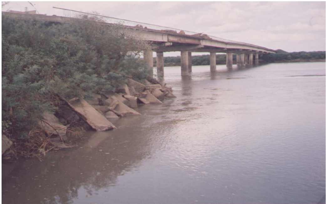
სურ. №25. მდ. რიონის გვერდითი ეროზიის ობიექტი - ხიდი აბაშა-სუჯუნა-კეთილარი-ჯაპანას საავტომობილო გზის მე-18 კმ.
