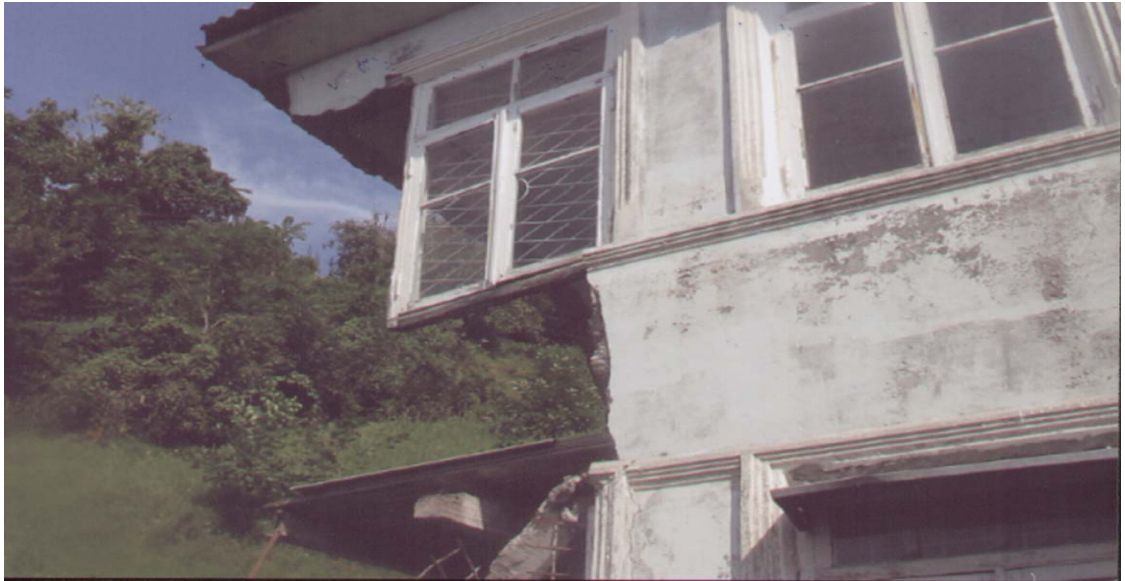
სურ №41. სოფელ ორთაბათუმში მეწრული პროცესებისგან სუსანა მემედის ასულ დუმბაძის საცხოვრებელი სახლი დეფორმირებულია
