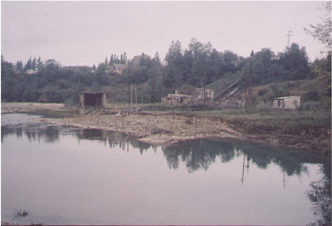
სურ №24. მდ. ოჩხომურის მარჯვენა ნაპირი დაბა ჩხოროწყუში, გვერდითი ეროზიით დაზიანებული "ჩხორჰესის" დამხმარე ნაგებობით და ძველი ნაპირსამაგრი კონსტრუქციების ნარჩენებით.
