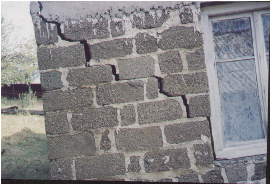
სურ №59. სოფელ კვაცხუთში გაჯირჯეზად გრუნტებზე აგებული დეფორმირებული საცხოვრებელი სახლი
